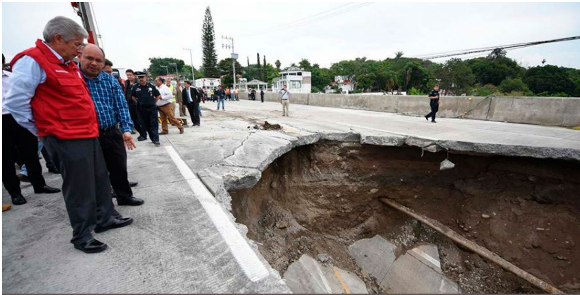
MÉXICO EN UN SOCAVÓN: Dos personas a bordo de un automóvil perdieron la vida en un hundimiento formado en el recién inaugurado Paso Express de Cuernavaca.
